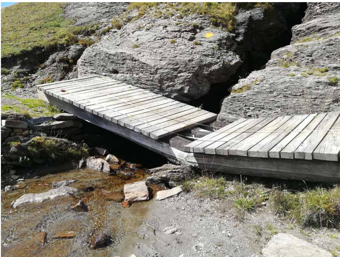
Foto 49: Intervento PT02. Passerella pedonale spezzata
