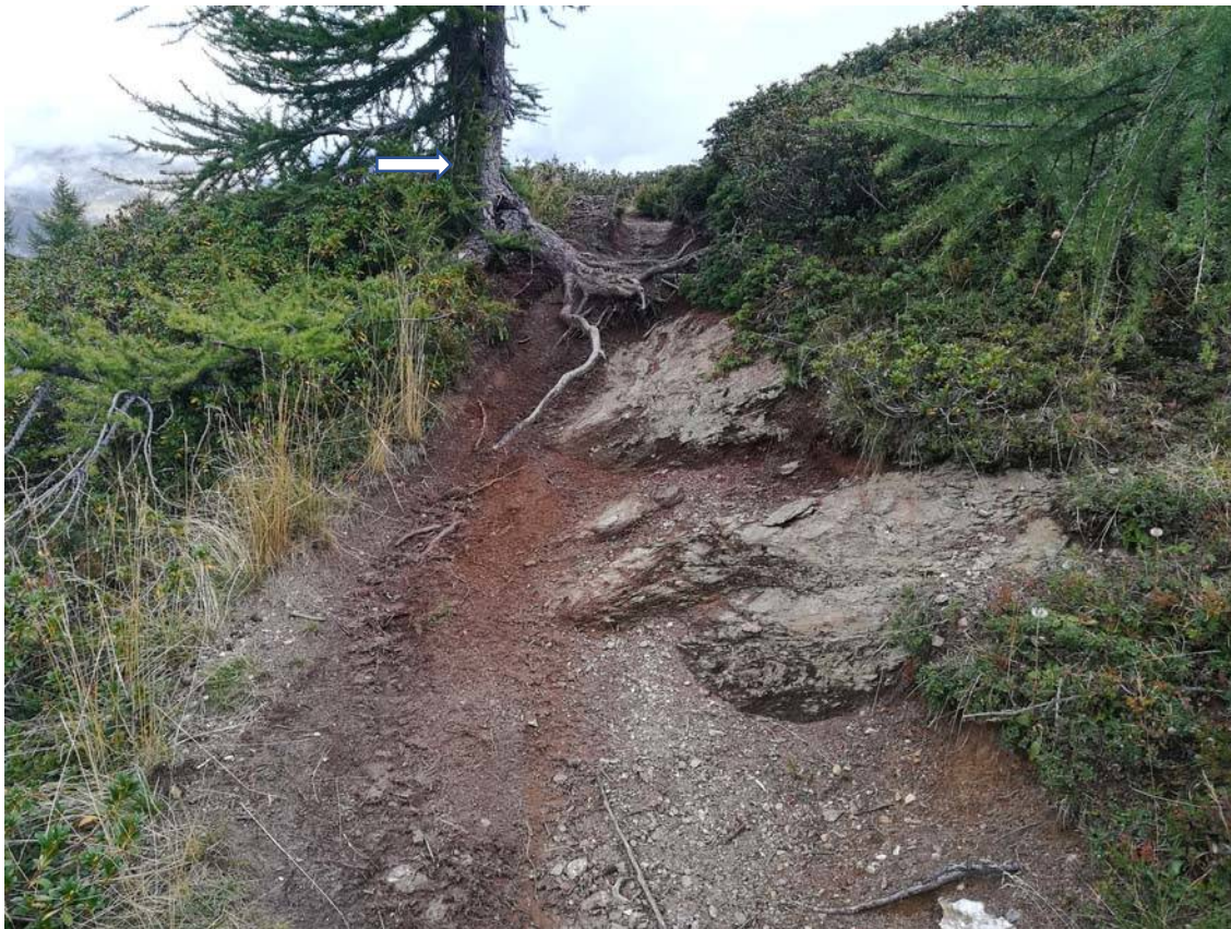
Foto 58: Intervento PT10. Pianta e radici da tagliare
